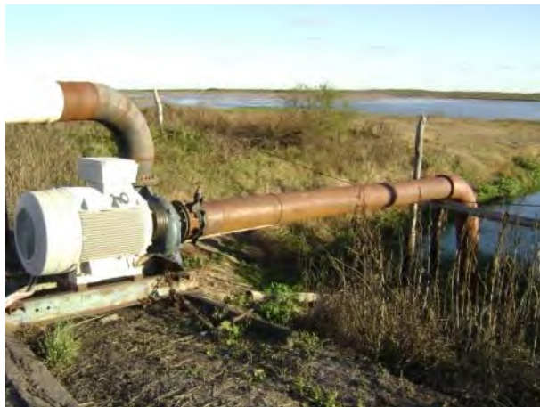
Instalaciones de bombeo en la represa de Garaycochea
