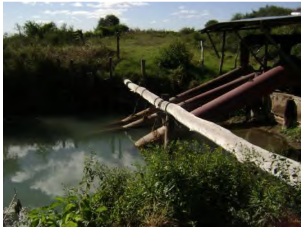
Instalaciones de bombeo de arrozera
